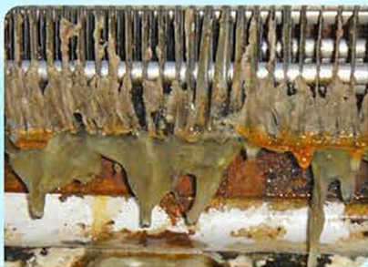
Moho dentro del refrigerador de exhibición
